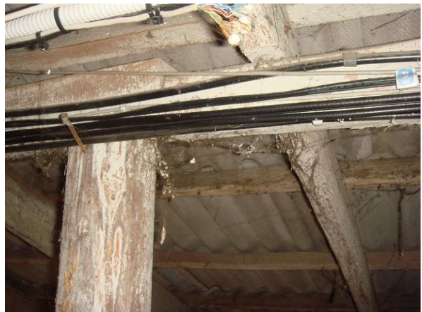
4.8.-6 (Deformācijas jumta krēsla kopturu savienojumos. Vājstrāvu tīklu sistēma. )
