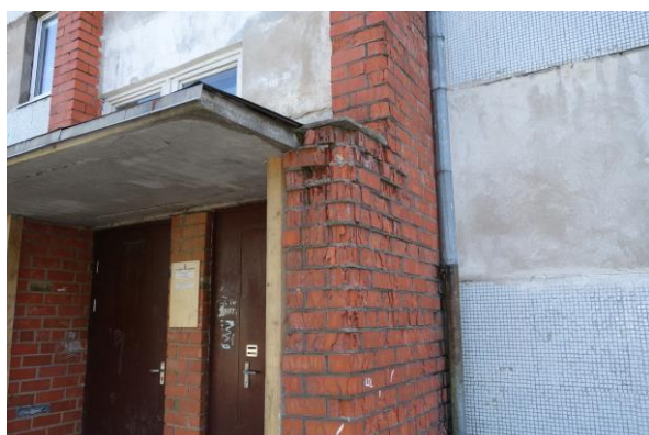
4.4-3 (Mūra izdrupumi kāpņu telpas pilastram)
