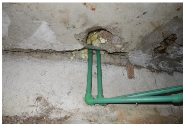
4.6-4 (Pagraba pārsegums. Pārseguma panelis. Paneļa pirmajā dobumā izkalts caurums, atsegts stiegrojums. Stiegrojums ar virsmas koroziju)
