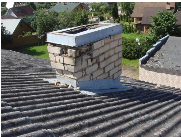
4.8-7 (Ventilācijas izvads uz jumta)
