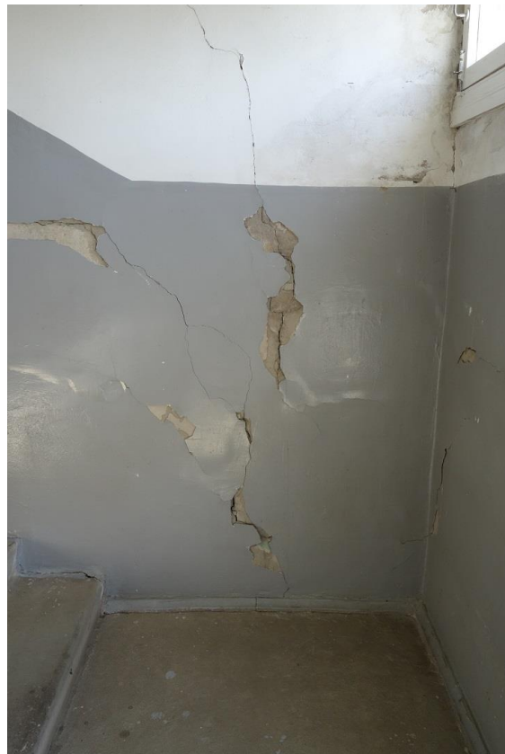
4.1.-2 (Plaisa 3.kāpņu telpā starp 1. un 2.stāvu, pie ārsienas)
