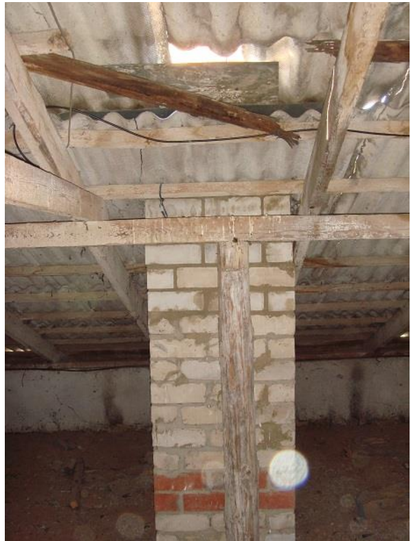
4.8.-4 (Jumta seguma bojājumi)
