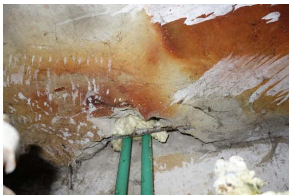
4.6-1 (Pagraba pārsegums. Pārseguma panelis. Paneļa pirmajā dobumā izkalts caurums, atsegts stiegrojums. Stiegrojums ar virsmas koroziju)
