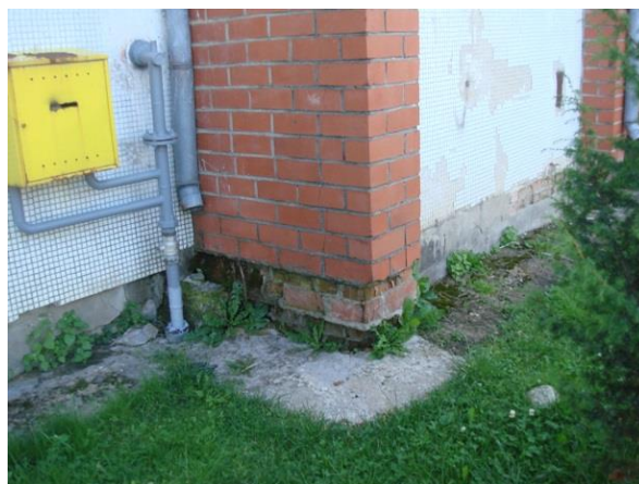
4.1.-6 (Rietumu fasāde. Cokola apmetuma bojājumi)
