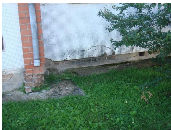
4.12-2 (Sienas paneļa bojājums A fasādē)
